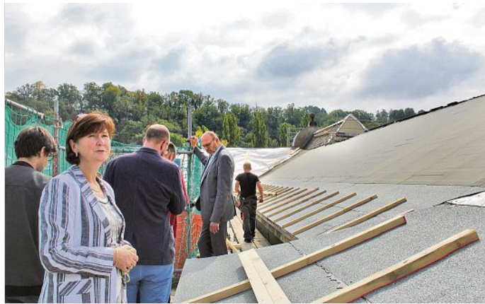
Optimistischer Blick von Schulleiterin Steffi Wenzel: Auf ihrem Schuldach werden künftig Photovoltaikanlagen das Schulhaus mit umweltfreundlichem Strom versorgen
